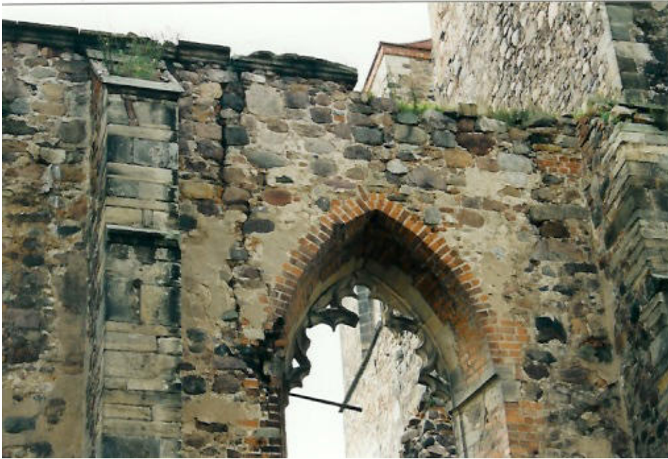
Zerstörte Mauerkrone vor 2001
