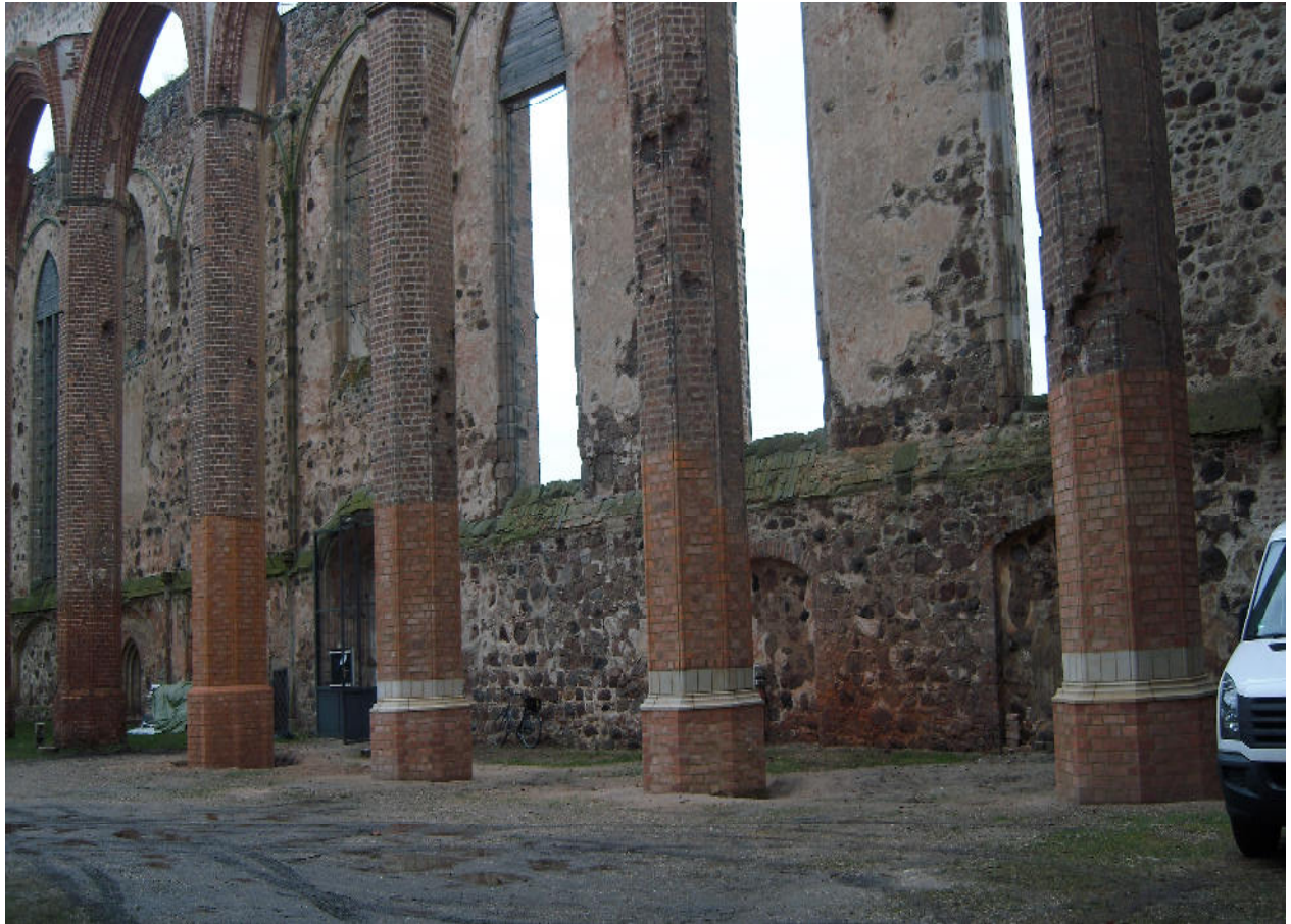
Pfeiler 2 und 3 stark beschädigt durch den Luftangriff
